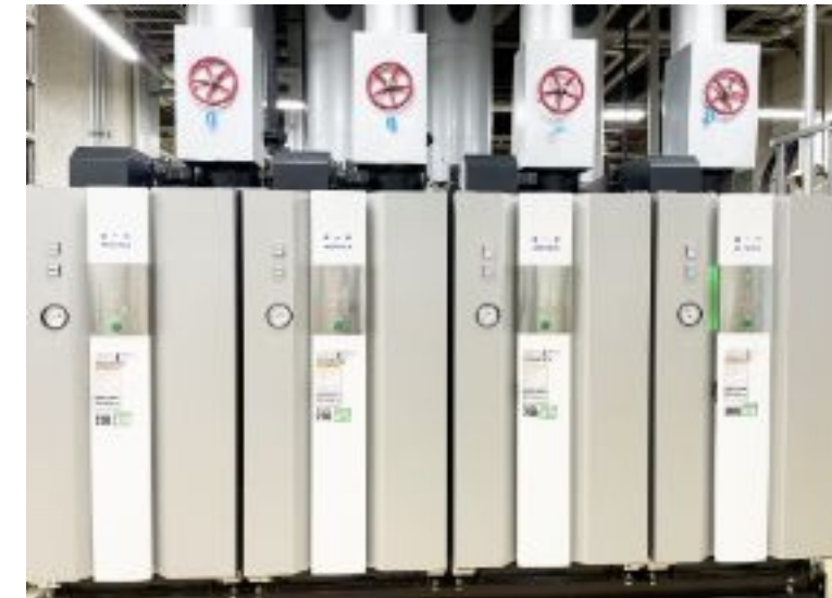
ボイラー (温熱)
