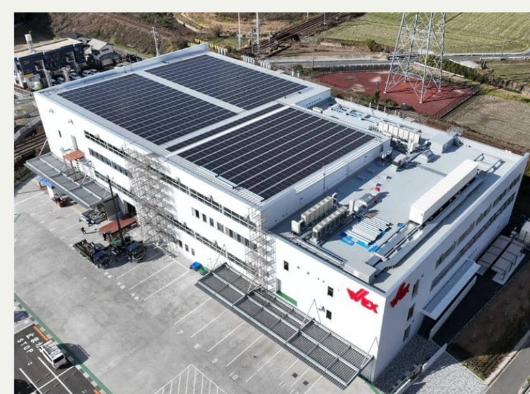
設置方式：屋根置き 福岡県筑紫野市
