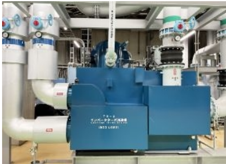
ターボ冷凍機 (冷熱)
