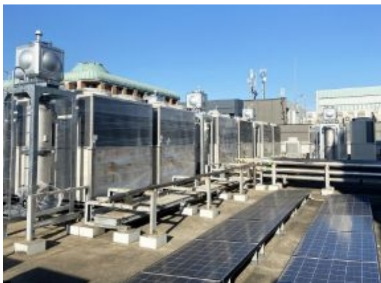
福岡市博多区 オフィスビル：空調改修工事 福岡市博多区
