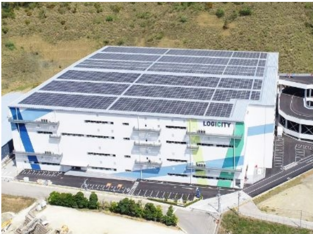
設置方式：屋根置き
